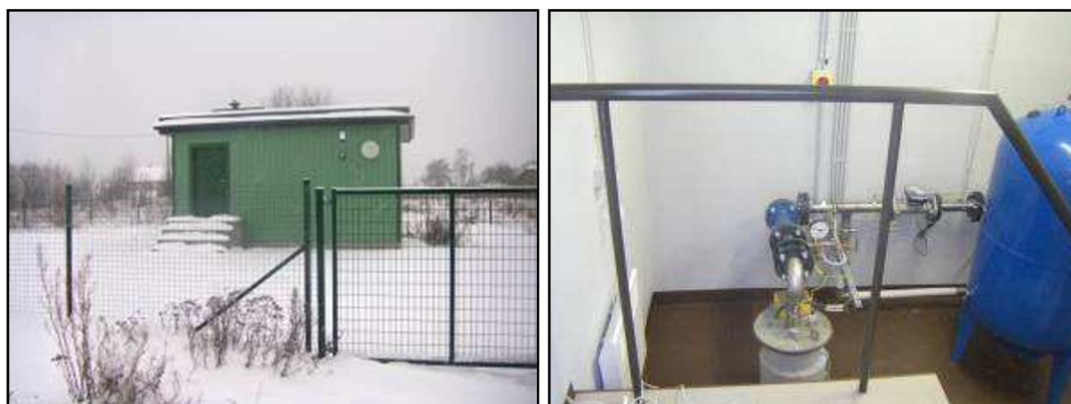
Joonis 4.7 Õuna puurkaev-pumpla välis- ja sisevaade
