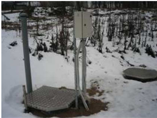
Joonis 5.5 Moe kanalisatsioonipumpla
