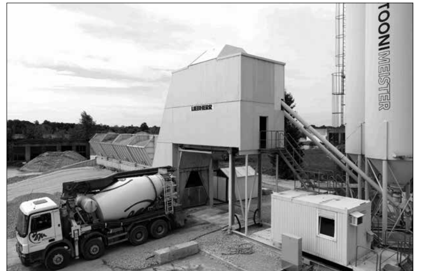
Современный мобильный бетонный завод Liebherr Mobilmix начал работу в Тапа. Фото из архива фирмы Betoonimeister
