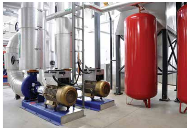
Оборудование современной котельной.
